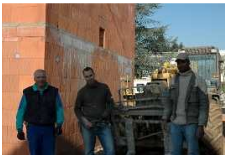
Les établissements Levêque-Bourdonnais de Faverolles-sur-Cher emploient deux salariés en insertion sur leur chantier rue des Gallières, dont Mohamed (à droite).
